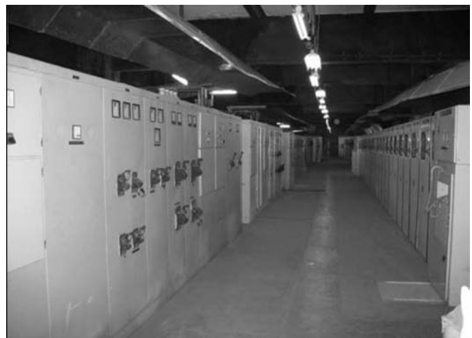
Разводно постројење 6,3 kV и 0,4 kV ТЕНТ-А
